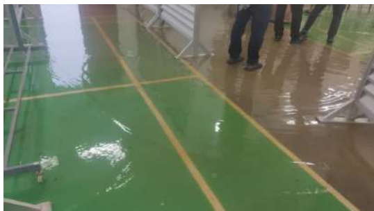
Foto 10: Banjir dalam Kompleks Sukan, Dewan Penyenggaraan JKR (tempat untuk pembukaan undi Pos).
